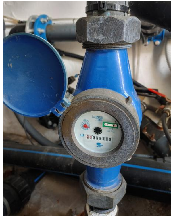
Ejemplo de contador de agua
